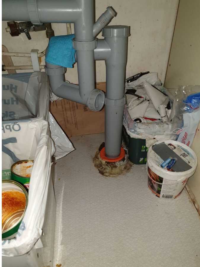
Diskbänksskåp med gammalt rostigt avlopp
