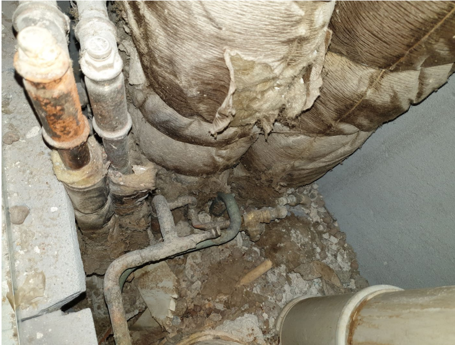
Rörschakt med många brister, ex ingen tät botten, ingen läckut, gamla spröda avloppsrör
