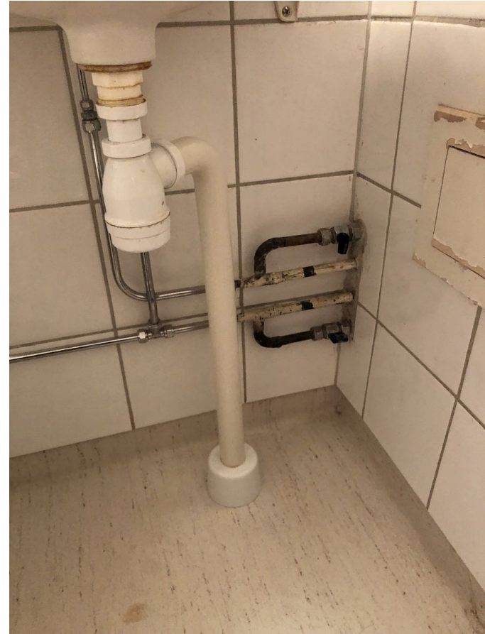
Rostangripna vattenledningar i våtrum
