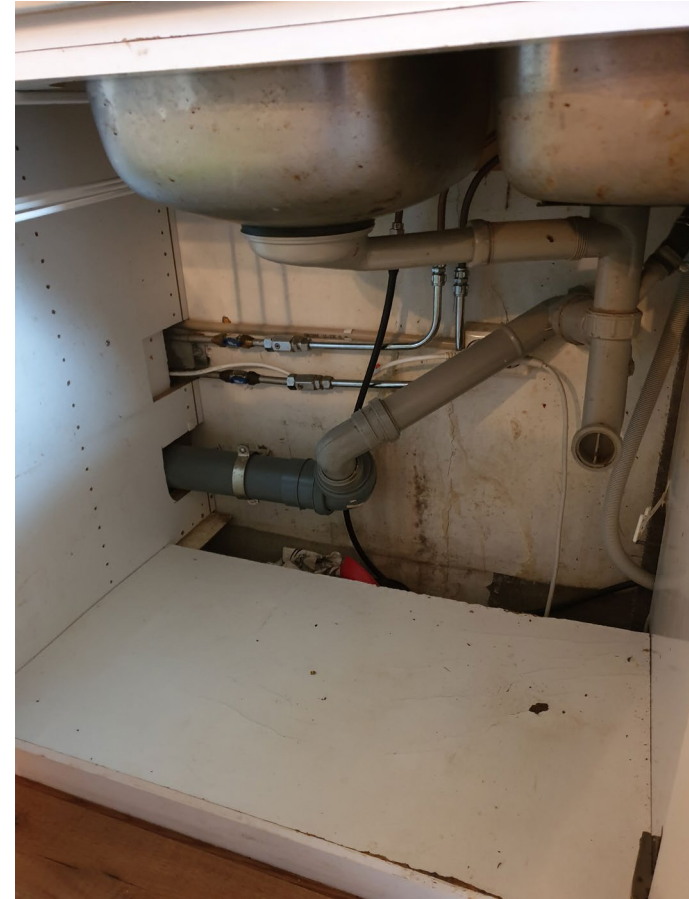
Diskbänksskåp med otät botten och riskfyllda vattenkopplingar
