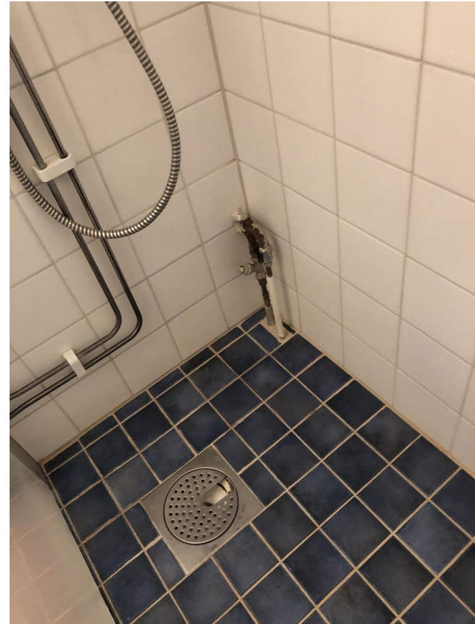
Värmeledning ur golv i duschplats i våtrum
