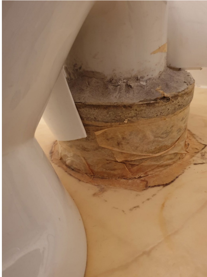
Rostig avloppsrör i i rörschakt i våtrum
