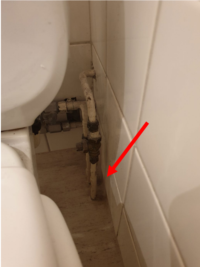
Rör genomföringar ur golv i våtrum
