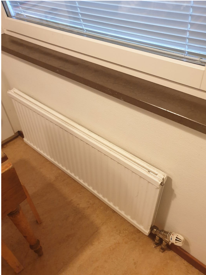
Radiator vid fönster
