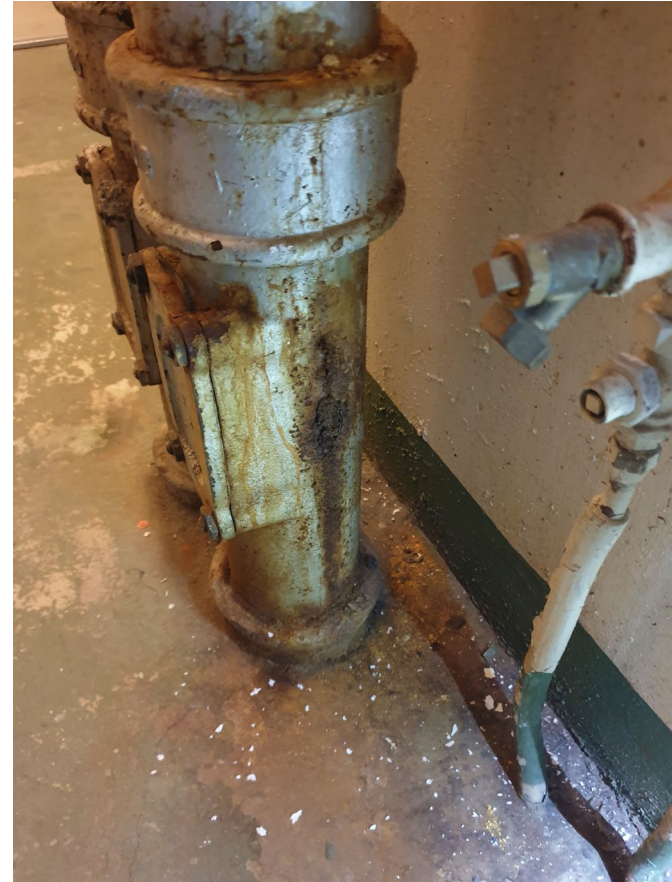
Rostigt avloppsrör på markplan
