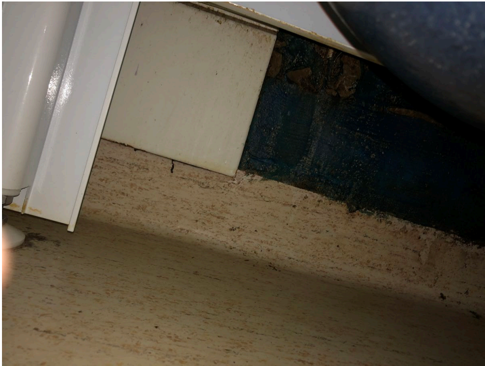
Kakelplattor saknas på vägg under badkar
