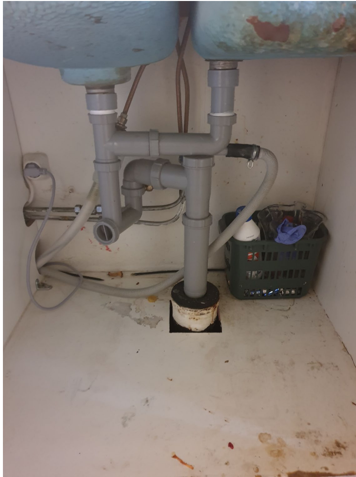
Kök i original med otät botten och dåliga rör
