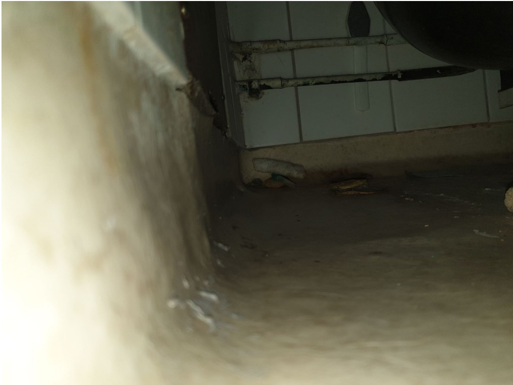
Bristfälliga rör genomföringar i vägg i våtzon i våtrum (under badkar)
