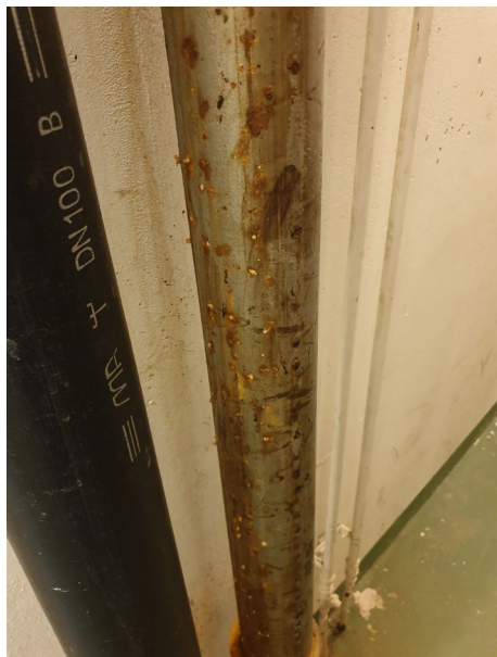
Rostigt avloppsrör i källargång
