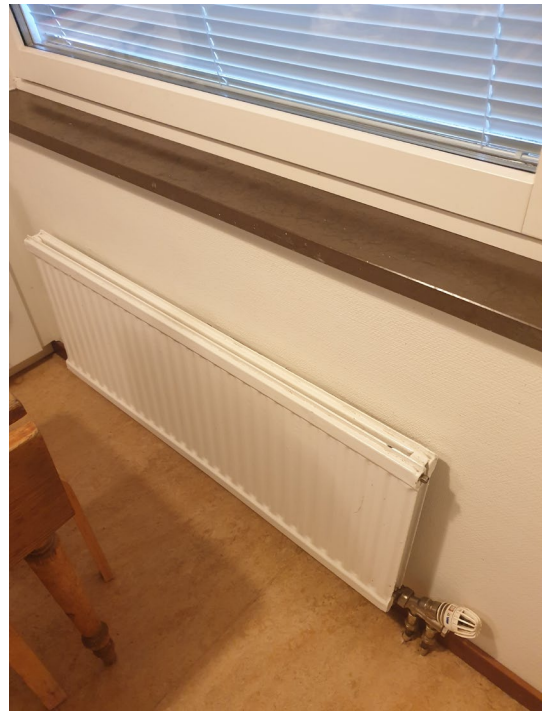
Radiator med ettrörsystem
