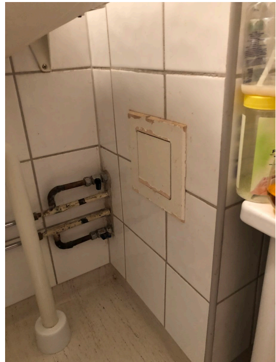
Otäta, bristfälliga rörgenomföringar
