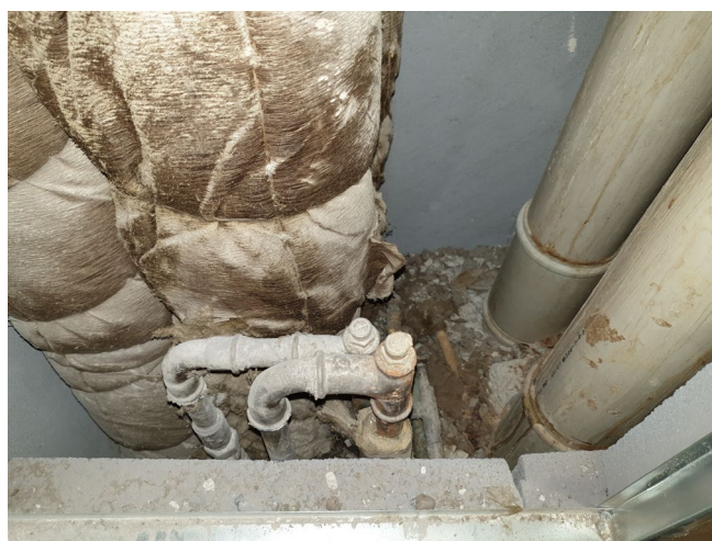
Gamla avloppsstammar i rörschakt
