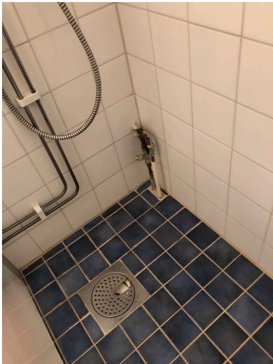
Värmeledningar ur golv i våtzon
