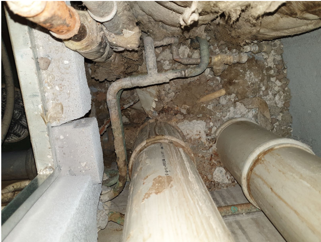
Rörschakt med otät botten (inget tätskikt) Bristfälliga rör genomföringar
